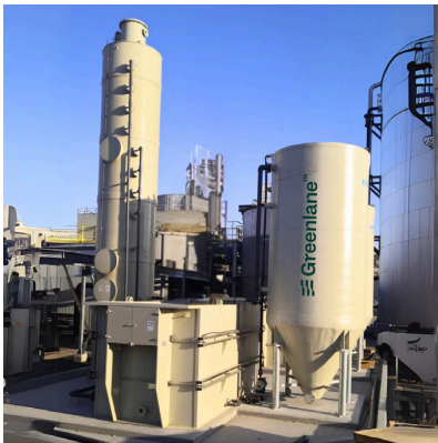
Instalação em cascata de H 2 S
