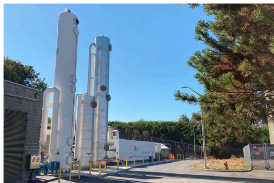
Instalação Cascade H 2 O
