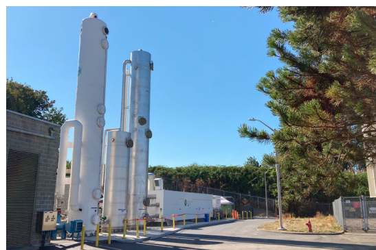
Instalação Cascade H 2 O
